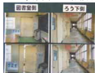
【かかれた危険箇所(図書室の出入口)】
